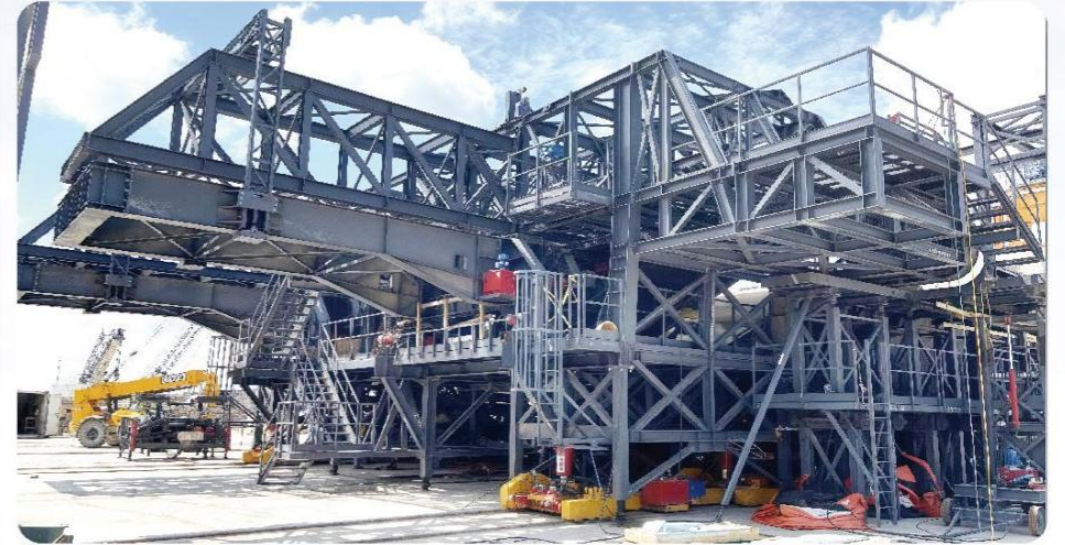
美国休斯敦节段项目 SEGMENT FORMWORK PROJECT AT HUSTON IN THE USA
